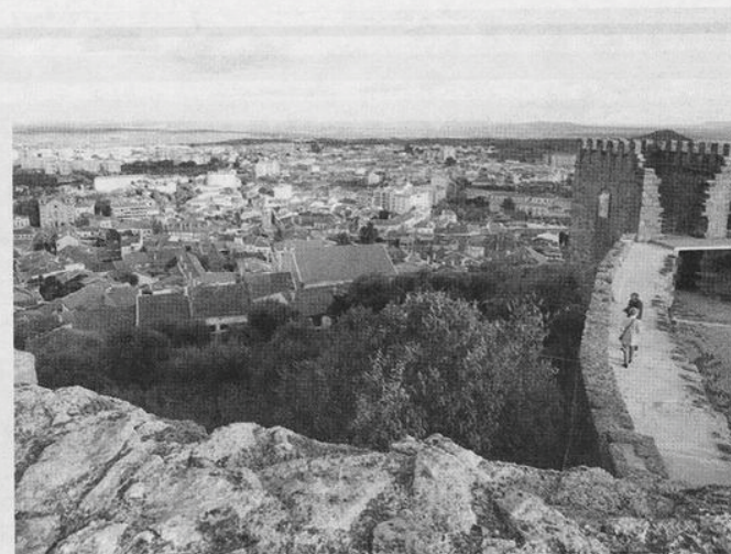
PERIGO. Os troços da muralha manuelina de Castelo Branco apresentam um avançado estado de degradação
